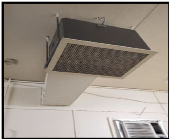
Exhaust Fan & Register
